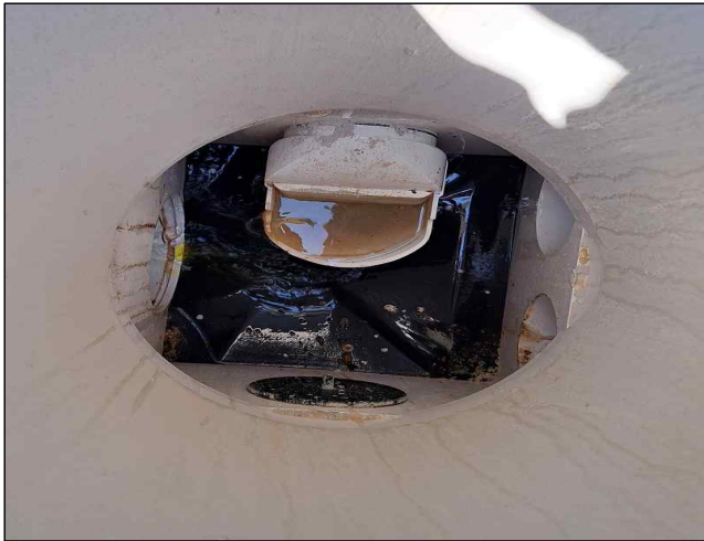
정화조 후단 악취방지시설(오수받이 형태 경우)
