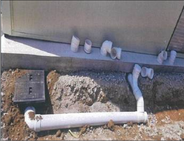
화장실 배관 및 생활오수 배관 전단 악취방지시설
