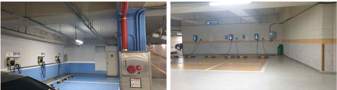
<그림 35> 화재감지기가 설치되지 않은 전기차 충전구역
