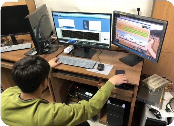
송천보외 4개소 원격감시제어 HMI 통합 및 계량공사(2020.10 ~ 2020.11)
